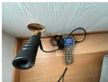
Fuktmåling i innforet trevegg.
