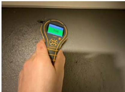
Fuktsøk i øvre del av vegg.
