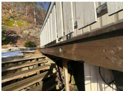
Skjevheter i bjelkelag.
