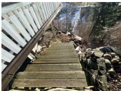
Mangler rekkverk på begge sider ved hage.
