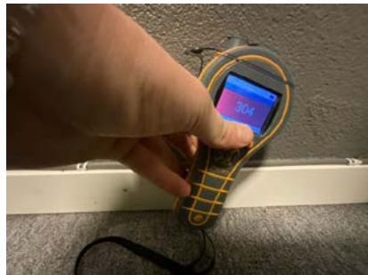
Økende fuktverdier i nedre del av vegg.
