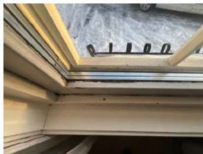
Noe malingsflass på enkelte vinduer.
