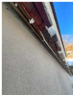
Ingen lufting i bakkant av kledning.
