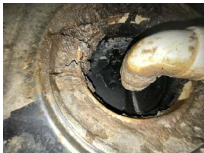
Sluk under dusjkabinett.
