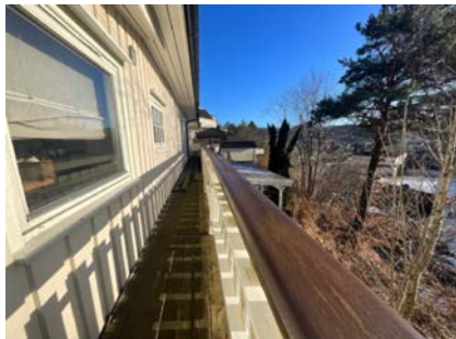
Ujevnheter i rekkverk.
