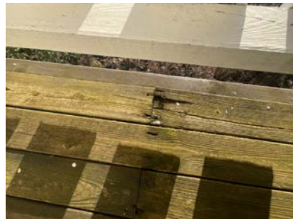
Værslitte terrassbord i front av verranda.
