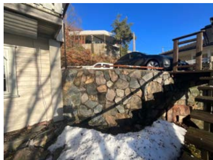
Manglende rekkverk på forstøtningsmur ved parkering.
