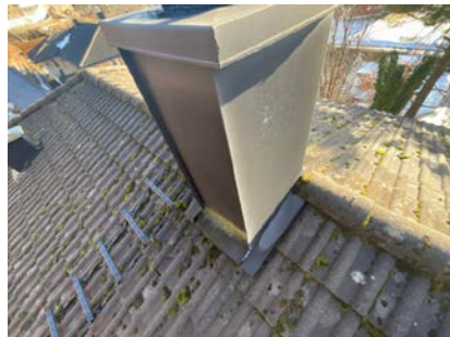
Beslag rundt pipe, noe flass.
