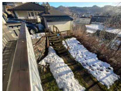
Rekkverk mangler på den ene siden
