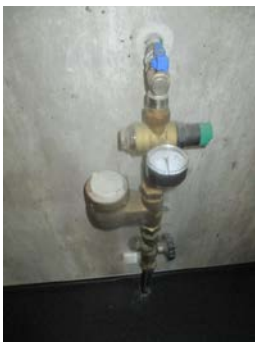
Innvendig hovedstoppekran med vannmåler i utleiedelen.
