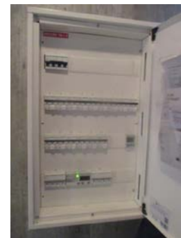
Sikringsskapet for hoveddelen.
