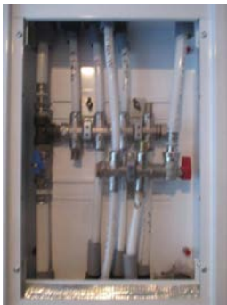
Fordelerskap på vaskerom i hoveddelen.
