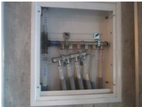
Fordelerskap på bad/vaskerom i utleiedelen.
