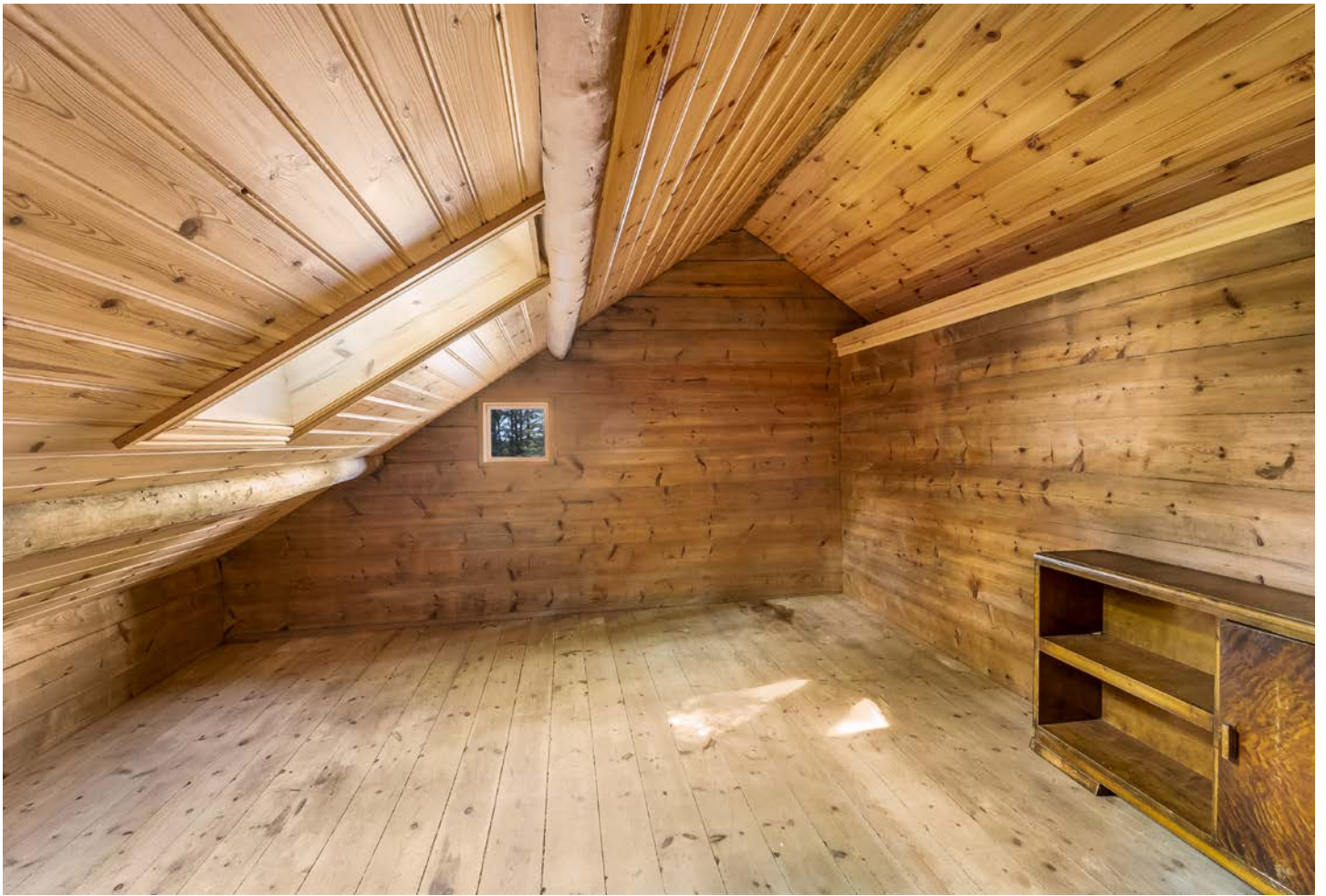
Rom på loftet benyttet som soverom. Megler gjør oppmerksom på manglende rømningsvei.
