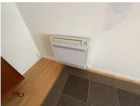
Varmepumpe innvendig aggregat.
