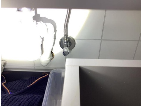
Utett mellom rør og vegg
