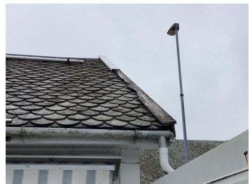
Skader på vannbord
