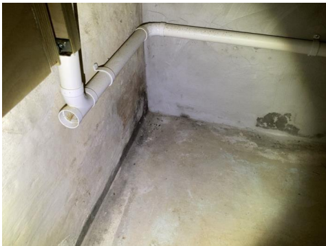
Indikasjoner på fukt i kjeller
