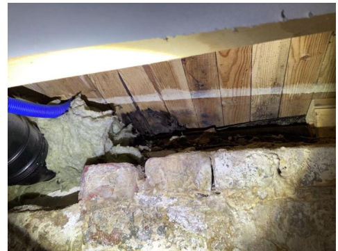
Eldre skader på bjelke / gulv
