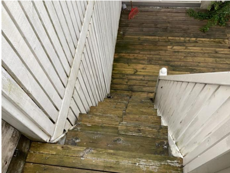
Samba trapp. Her er det ikke håndløper på vegg
