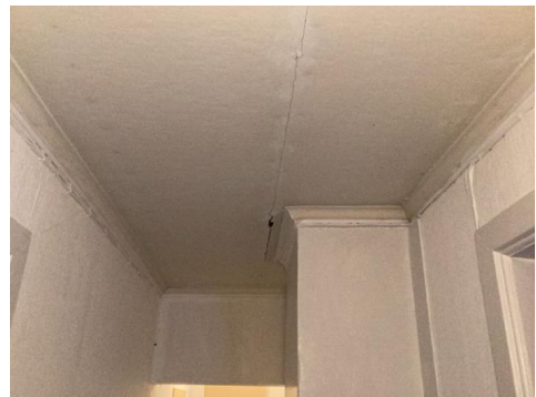
Mindre skader i himling
