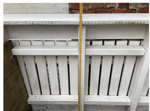
Rekkverk er lavere enn dagens krav
