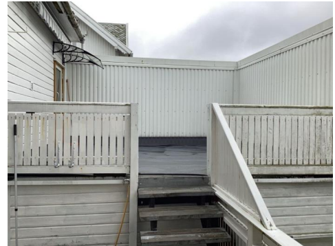
Det er ikke montert rekkverk.
