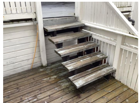
Rekkverk er lavere enn dagens krav
