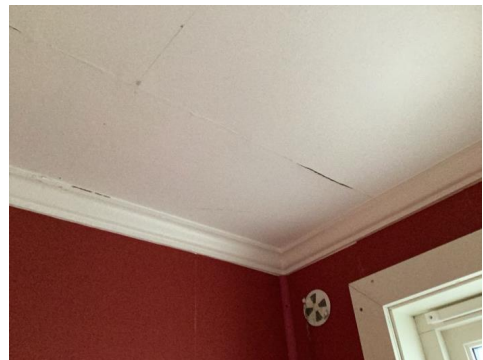
Mindre skader i himling
