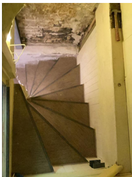
Trapp har ikke håndløper på vegg
