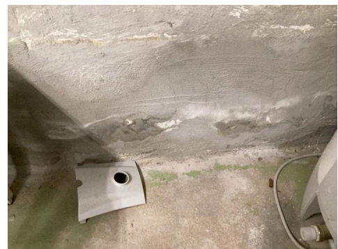
Saltutslag på mur i kjeller
