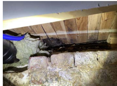
Eldre skader på bjelke / gulv
