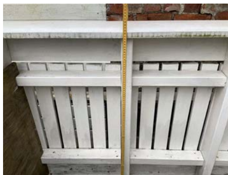
Rekkverk er lavere enn dagens krav
