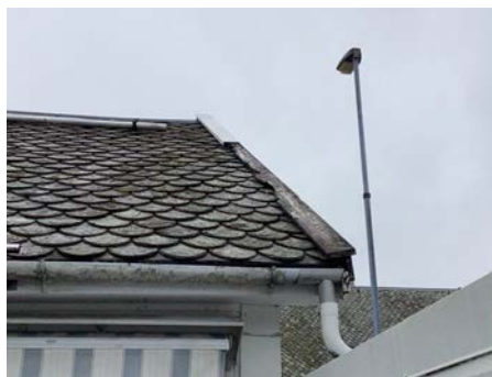
Skader på vannbord
