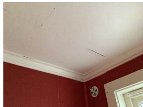
Mindre skader i himling
