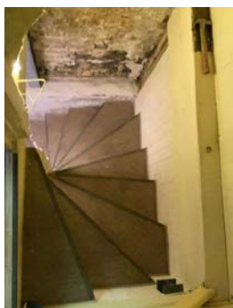
Trapp har ikke håndløper på vegg
