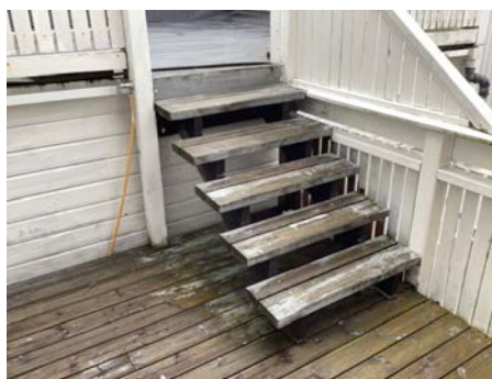
Rekkverk er lavere enn dagens krav
