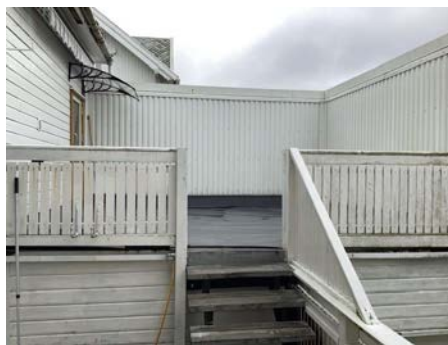
Det er ikke montert rekkverk.
