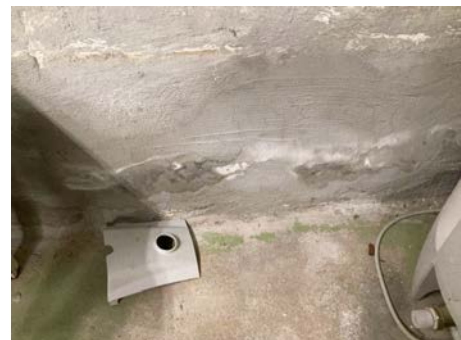
Saltutslag på mur i kjeller
