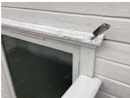
Vannbord bør skiftes
