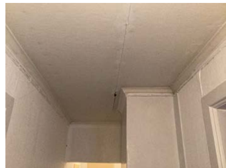
Mindre skader i himling
