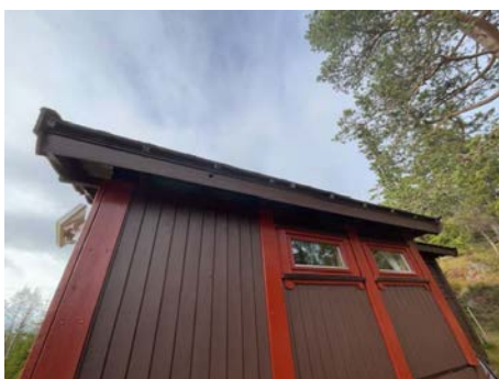
Manglende beslag, renner og nedløp.
