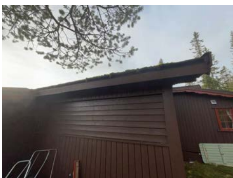
Manglende beslag, renner og nedløp.
