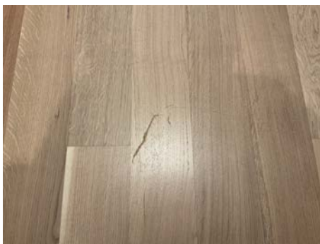
Synlig skade i overflaten på parkett i gang.
