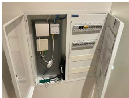
Sikringsskap i gang.
