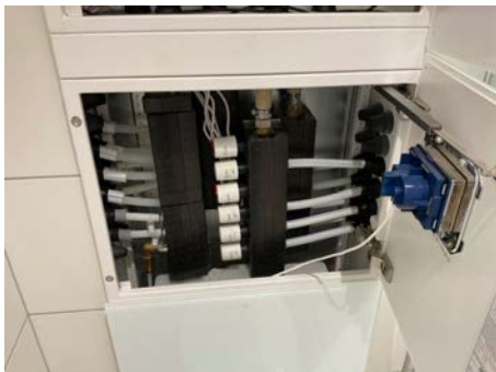
Rør i rør skap over toalett på bad.
