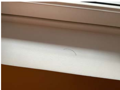
Skade maling i vindu på soverom.
