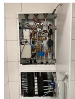
Skap for vannbåren varme over toalett på badet.
