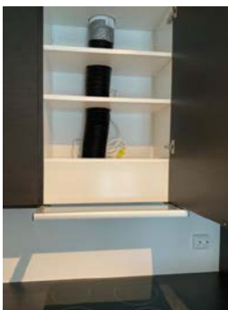
Vifte over koketopp. Kanal i skap.
