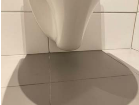
Ikke synlig dreneringshull under toalett på toalett rom
