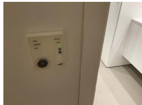
Styring for ventilasjon på vegg utenfor badet.
