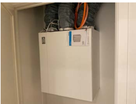
Ventilasjonsaggregat i kott.
