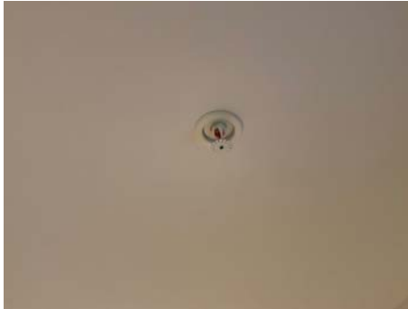
Ett av sprinklerhodene til sprinkleranlegget.
