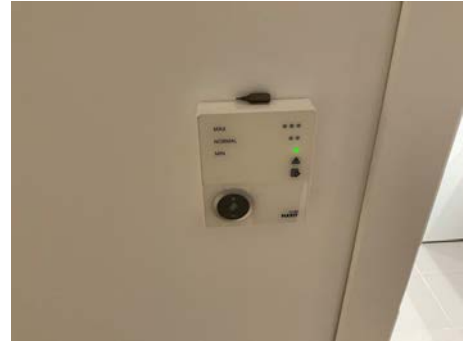
Styringsenhet for ventilasjonsanlegg utenfor badet.
