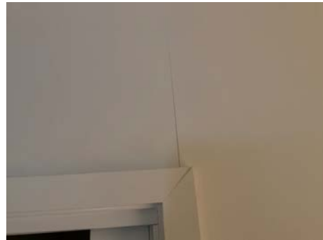
Sprekk i vegg over skyvedør på soveroms siden.
