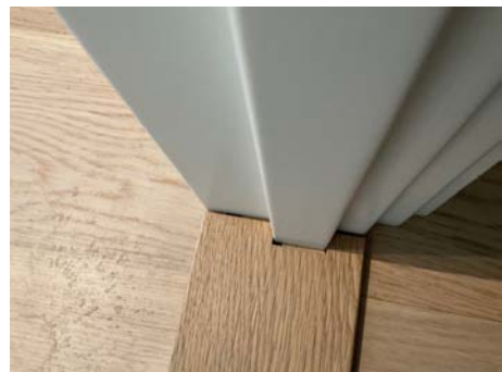
Synlig sprekk mellom svill og dørkarm.
