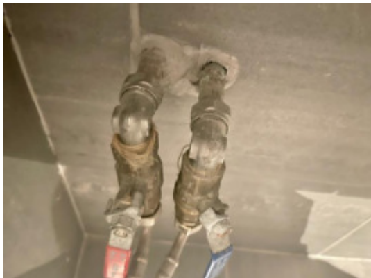
Rør i vegg uten mansjettmembran
