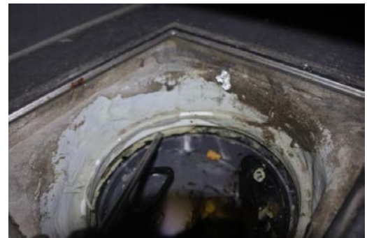
Sluk under baderomsinnredning.
