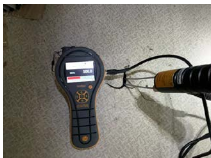
Svikt og fuktskadet gulv under gulvbelegg.
