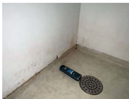
Defekte overflater i dusjsonen.
