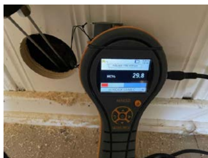
Hulltaking - Fuktmåling - Skadelig høyt fuktinnhold i den innfode trekonstruksjonen.
