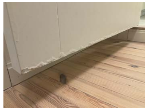
Baderomsdør har slitasje i bunn av dørblad
