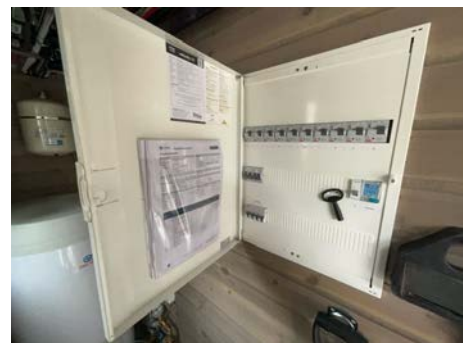
Skap på yttervegg.
