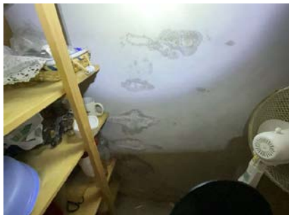
Kalkutslag / fuktavtrykk i åpen murkonstruksjon.
