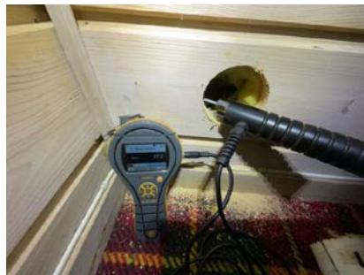
Hulltaking - Fuktmåling - Skadelig høyt trefuktinnhold i den innforede konstruksjonen.
