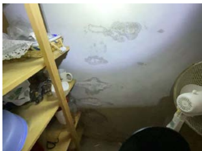
Kalkutslag / fuktvandring i åpen murkonstruksjon.
