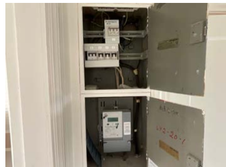
Sikringskap på loft.
