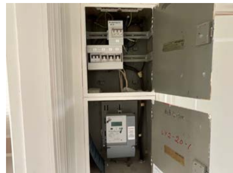
Sikringskap på loft.
