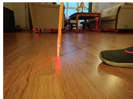
Måling i stue viser høydeforskjell på 11 mm over 2 meter.
