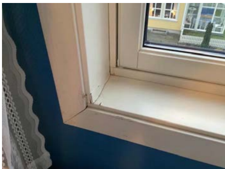
Fuktskade på foring
