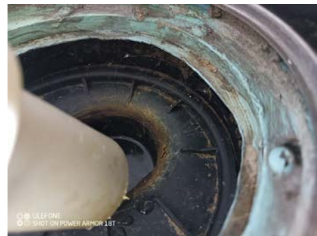
Sluk under kabinett er det påvist membran under klemring
