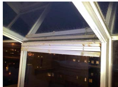
Lekkasje i overganger.
