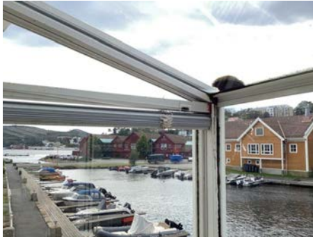
Rustskader på installasjon
