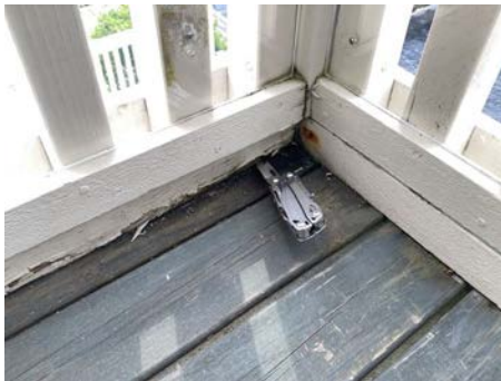
Råteskade i bord
