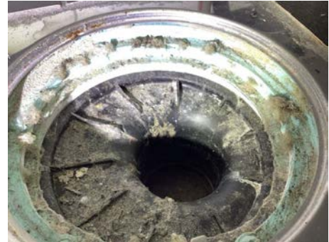
Sluk under innredning er det påvist membran under klemring
