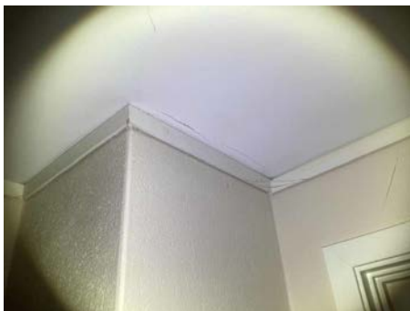
Mindre riss i himling ved pipe.
