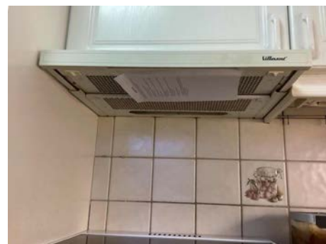
Ventilator er testet og fungerer.
