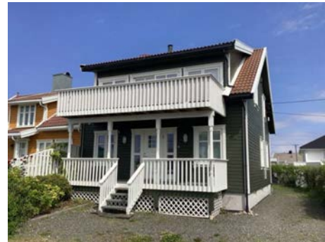
Mindre deler av tak mangler snøfangere
