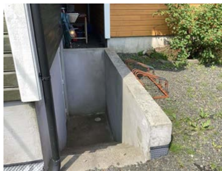
Rekkverk må monteres
