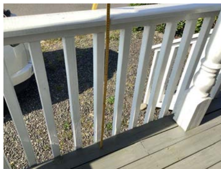
Rekkverk er lavere enn dagens krav
