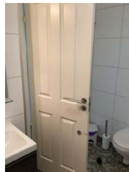
Dør til bad står skjevt og åpner seg selv, samt at dørblad har skade.
