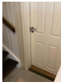
Dørblad til vaskekjeller tar i karm
