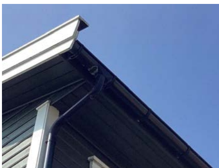
Lekkasje ved nedløpskum
