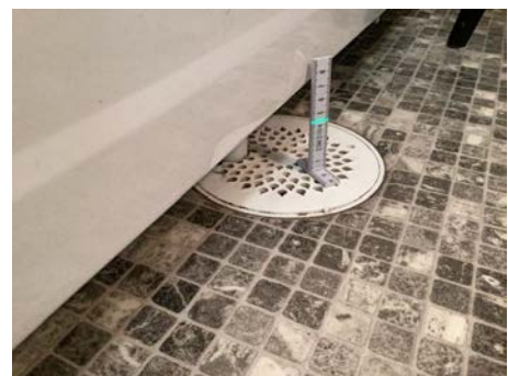
Måling ved sluk ved badekar
