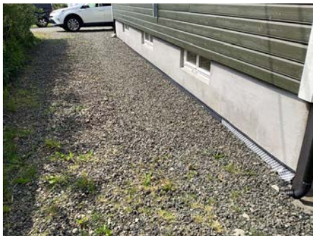
Drenerende masser rundt bygg. Om man skal asfaltere, må man påse at det blir fall fra grunnmur
