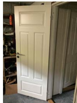
Dør til bod i kjeller er skjevt montert.
