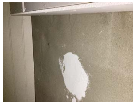
Riss i mur ved trapp til kjeller
