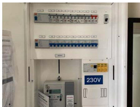
Anlegg med automatsikringer og overspenningsvern
