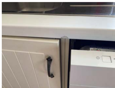
Mindre knatt på benkeplate
