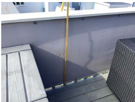
Rekkverk er lavere enn dagens krav.
