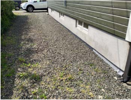
Drenerende masser rundt bygg. Om man skal asfaltere, må man påse at det blir fall fra grunnmur
