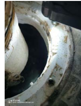
Sluk under kabinett med klemt belegg under klemring
