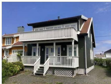
Mindre deler av tak mangler snøfangere
