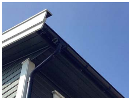
Lekkasje ved nedløpskum
