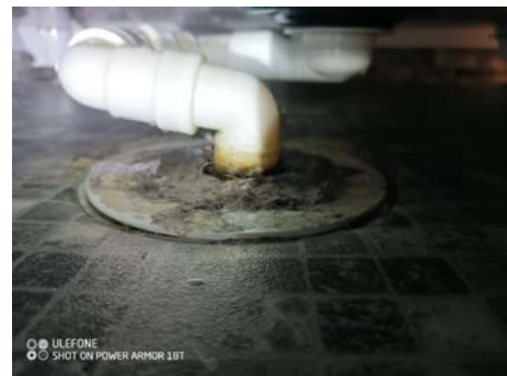
Sluk under kabinett må rengjøres
