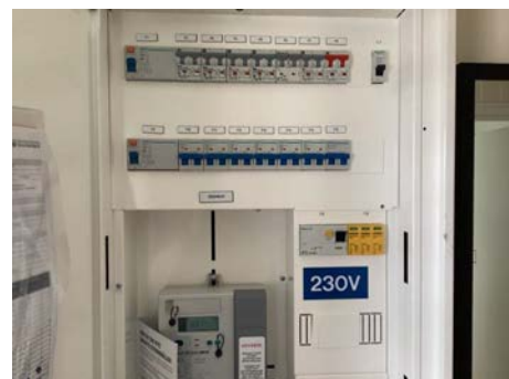
Anlegg med automatsikringer og overspenningsvern
