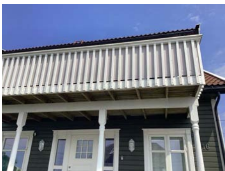
Rust på innfesting
