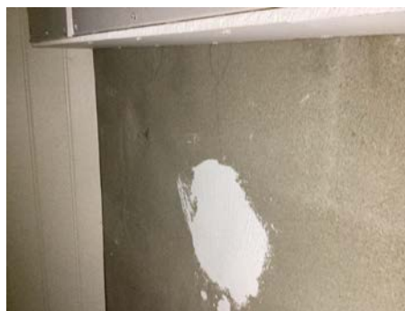
Riss i mur ved trapp til kjeller
