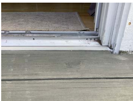
Oppkant ved dør er for liten
