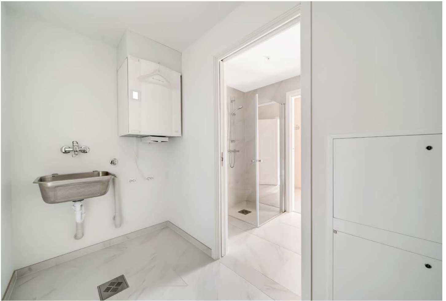
Vaskerom med tekniske installasjoner.
