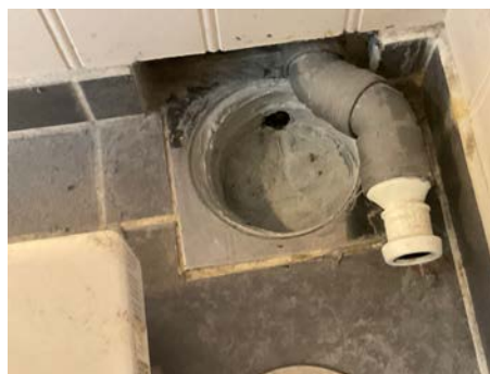
Sluk under dusjkabinett.
