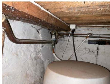
Vannrør i kobber.
