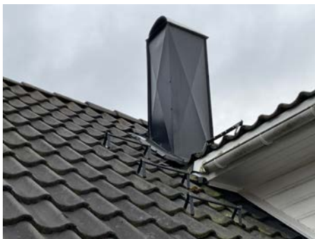
Tegn til slitasje på pipebeslag.
