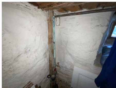
Vannmåler og stoppekran.
