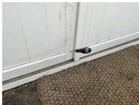
Råteskade i dør
