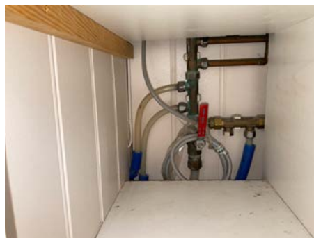
Fordelerstokk på bad loft.
