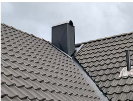
Pipe plassert i kilrenne.
