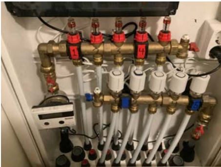
Fordelerskap til vannbåren varme.
