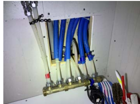
Innvendig fordelersats i bad/vaskerom.
