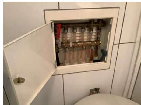
Kontrollskap i leilighet.
