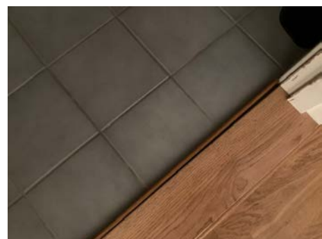
Enkelte løse feielister.
