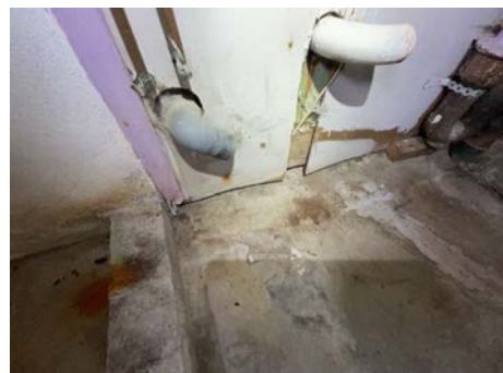
Bilde viser eks. på avløpsrør som ledes fra hybelkjøkken til gulv i tilstøtende rom.
