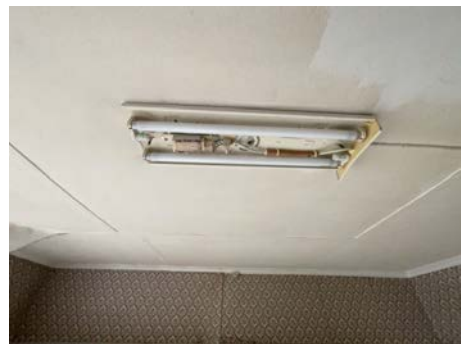
Bilde viser eks. på defekt lysarmatur
