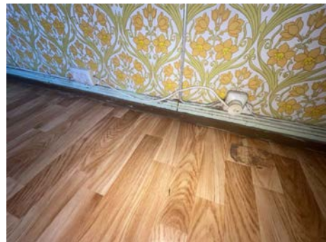
Bilde viser eks. på ikke fagmessig utførelse (TG 3)
