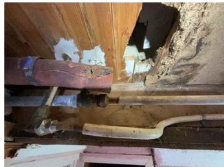
Bilde viser eks. på defekt og frakoblet avløpsrør fra kjøkken i 1. etasje
