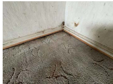
Bilde viser eks. på svikt/skade på gul/underlag i stue i kjeller.
