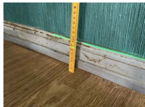
Utkastrek på laser er 11 cm på målestokk. Bilde viser over 40 mm høydeforskjell gjennom rommet i stue i 1. etasje.
