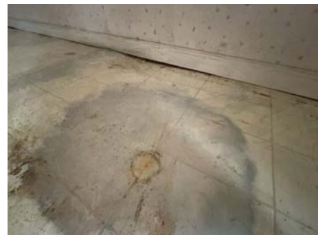
Bilde viser eks. på svikt/skade på gulv på kjøkken i kjeller.
