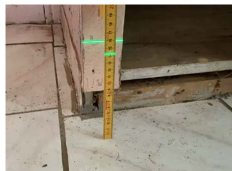
Utkastrek på laser er 11 cm på målestokk. Bilde viser over 30 mm høydeforskjell innenfor 2 meter i gang i kjeller.
