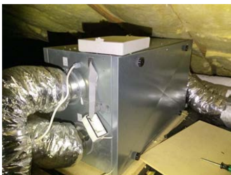
Anlegg med nytt filter
