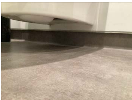
Det mangler synliggjøring for lekkasjevann
