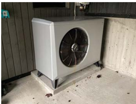
Inverter for varmepumpe og vannbåren varme
