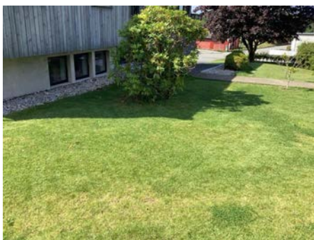
Fall fra grunnmur
