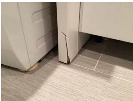
Fuktskade og sprekk på plate
