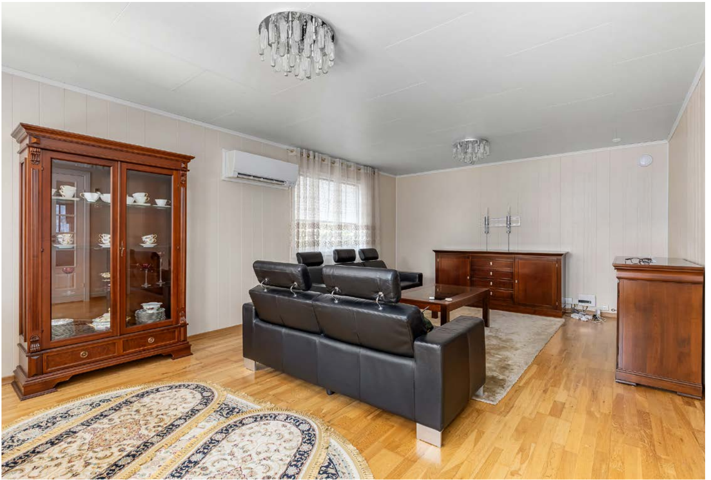
Varmepumpe i stue
