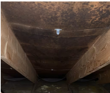
Fuktmerker i undertak.
