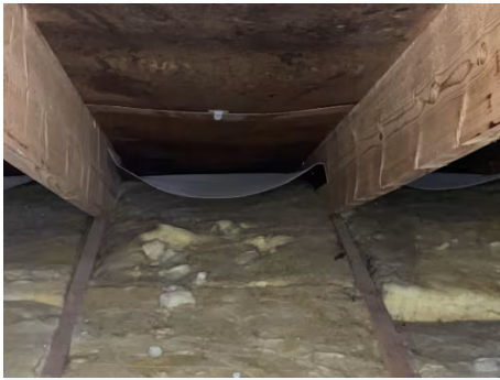
Det er luftespalte ned i gesims.
