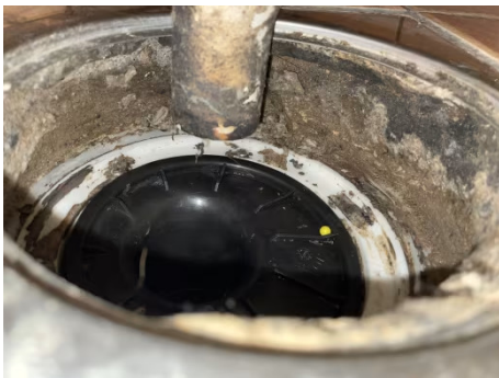
Ikke synlig tettesjikt i sluk.
