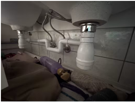
Avløp i sevantskap på bad.
