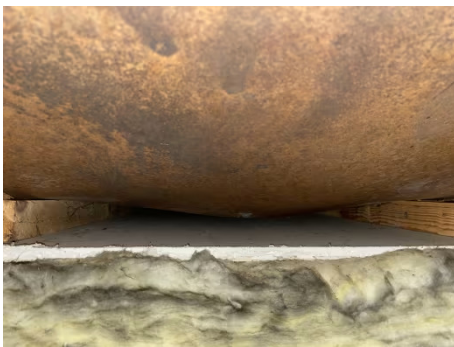
Undertaksplate sperrer delvis for luftespalte i skråhimling.
