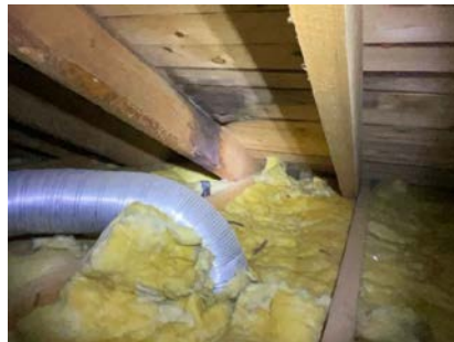
Kondensering fra feil kloakklufting på kryploft.
