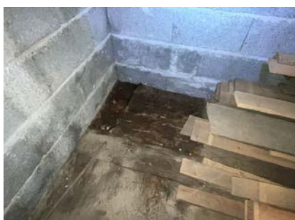
Oppfuktet kryssfiner-plater mot terreng.
