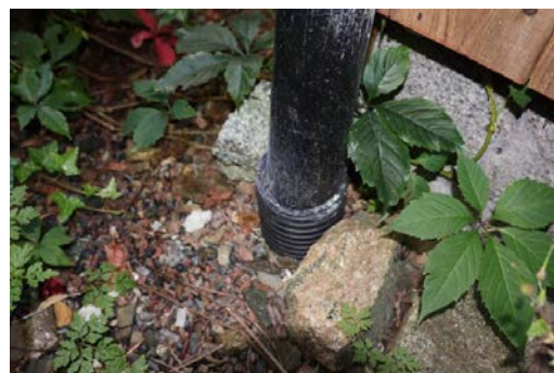
Noen rør går i bakken.
