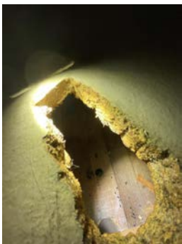
Synlig muselort under innredning.
