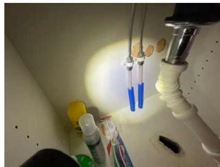
Det mangler tettmuffer under servant på toalettrom.
