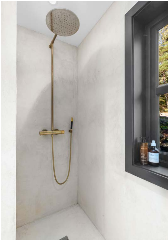
Her er det monterte særegne og eksklusive armaturer i fra Tapwell i messing over vask og i dusjnise.
