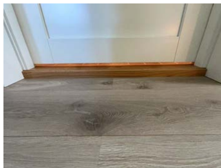
Spalte under dør.
