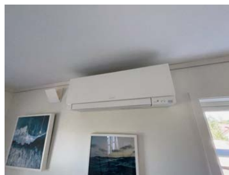
Varmepumpe innvendig aggregat.
