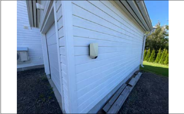
Elbillader på bod.
