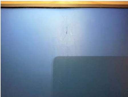
Bilde viser eks. på ujevnheter på vegger
