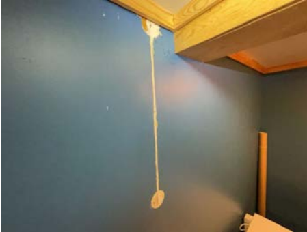
Bilde viser eks. på merker etter tidligere installasjoner
