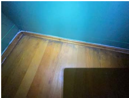
Bilde viser eks. på misfarging på gulv i kjeller langs vegg.
