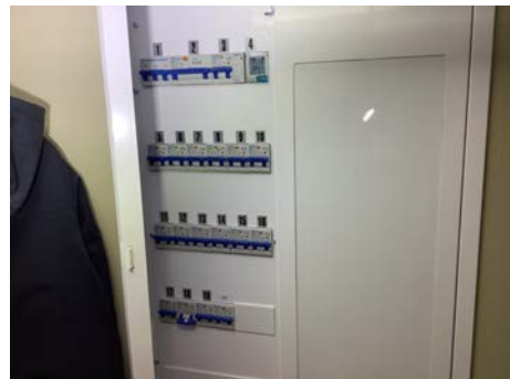
Sikringsskap står montert bak skyvedørgarderoben i entré.
