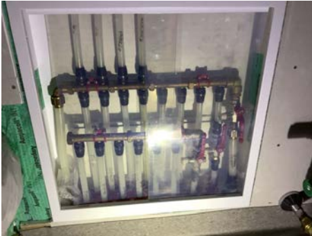
Kontrollskap for røropplegget.
