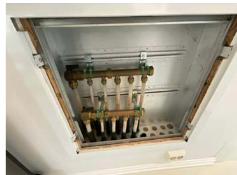
Fordelerskap i 2. etg.
