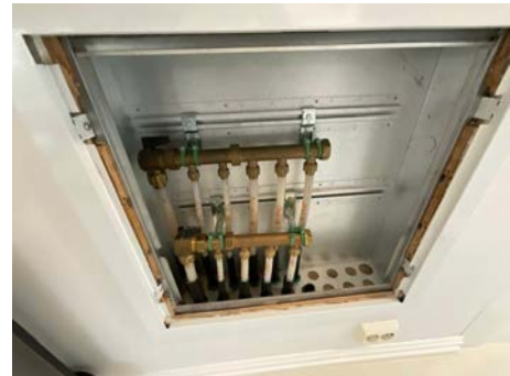
Fordelerskap i 2. etg.
