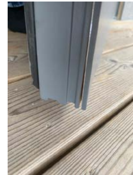
Inngangsdøren har litt sprekk i bunn av dørbildet. TG 2
