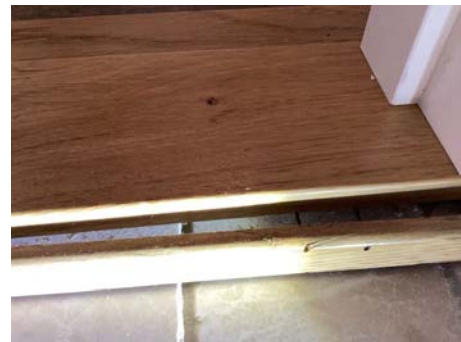
Ingen synlig membran ved terskel
