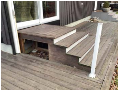
Trapp mangler rekkverk
