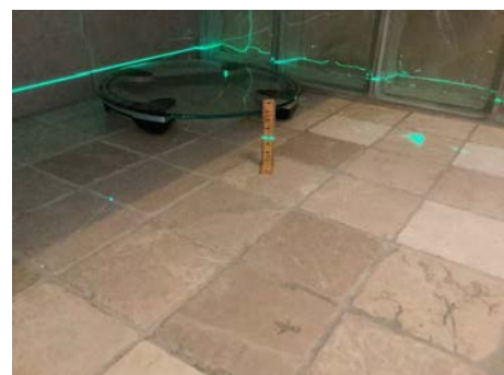
Fall på gulv under vask mot glassvegg.
