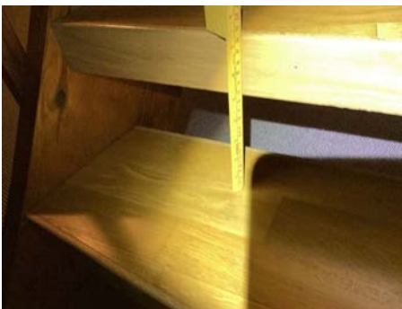
Det er ikke sikring mellom trinn
