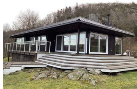
Taket har ikke snøfangere
