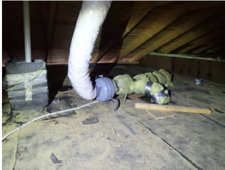
Avtreksvmodul av nyere dato
