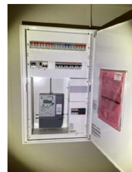
Sikringskap med kursfortegnelse
