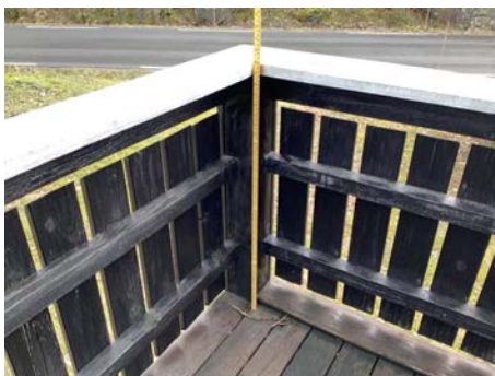
Rekkverk er lavere enn dagens krav.
