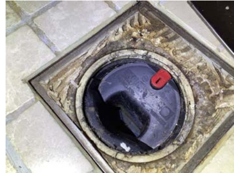
Membran i sluken virker å være belegg av eldre dato
