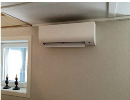
Varmepumpe i kjellerstue
