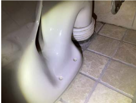
Ukjent membran løsning ved rør
