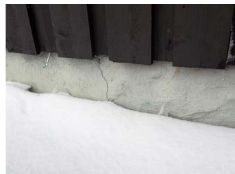
Riss / sprekk i puss på grunnmur.
