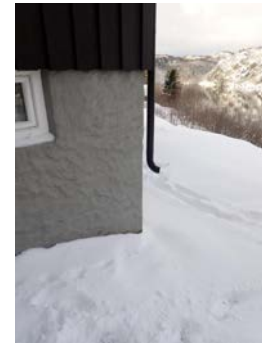
Det er kun etablert utkast, vann bør ledes bor fra boligen
