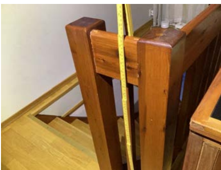
Rekkverk er lavere enn dagens kravavstand mellom spiler er større enn kravet
