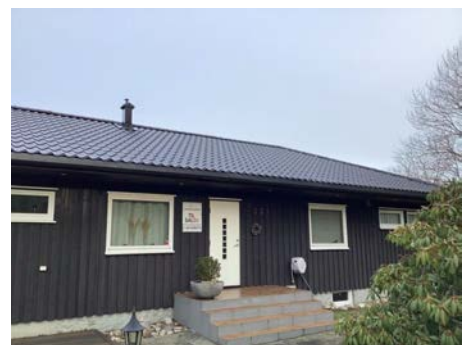
Taket har ikke snøfangere
