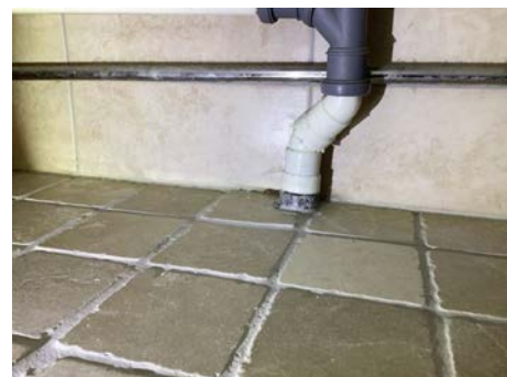
Ukjent membran løsning ved rør
