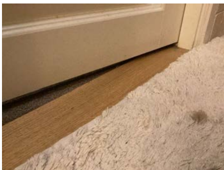
Spalte under dør
