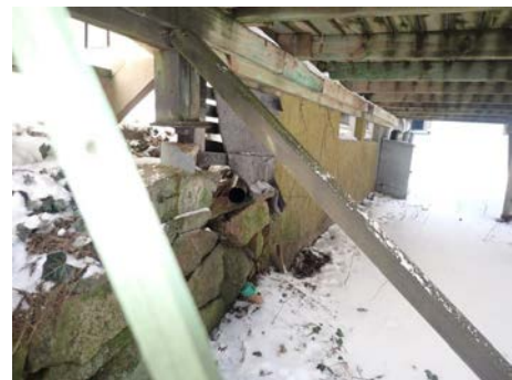
Det er kun etablert utkast, vann bør ledes bor fra boligen
