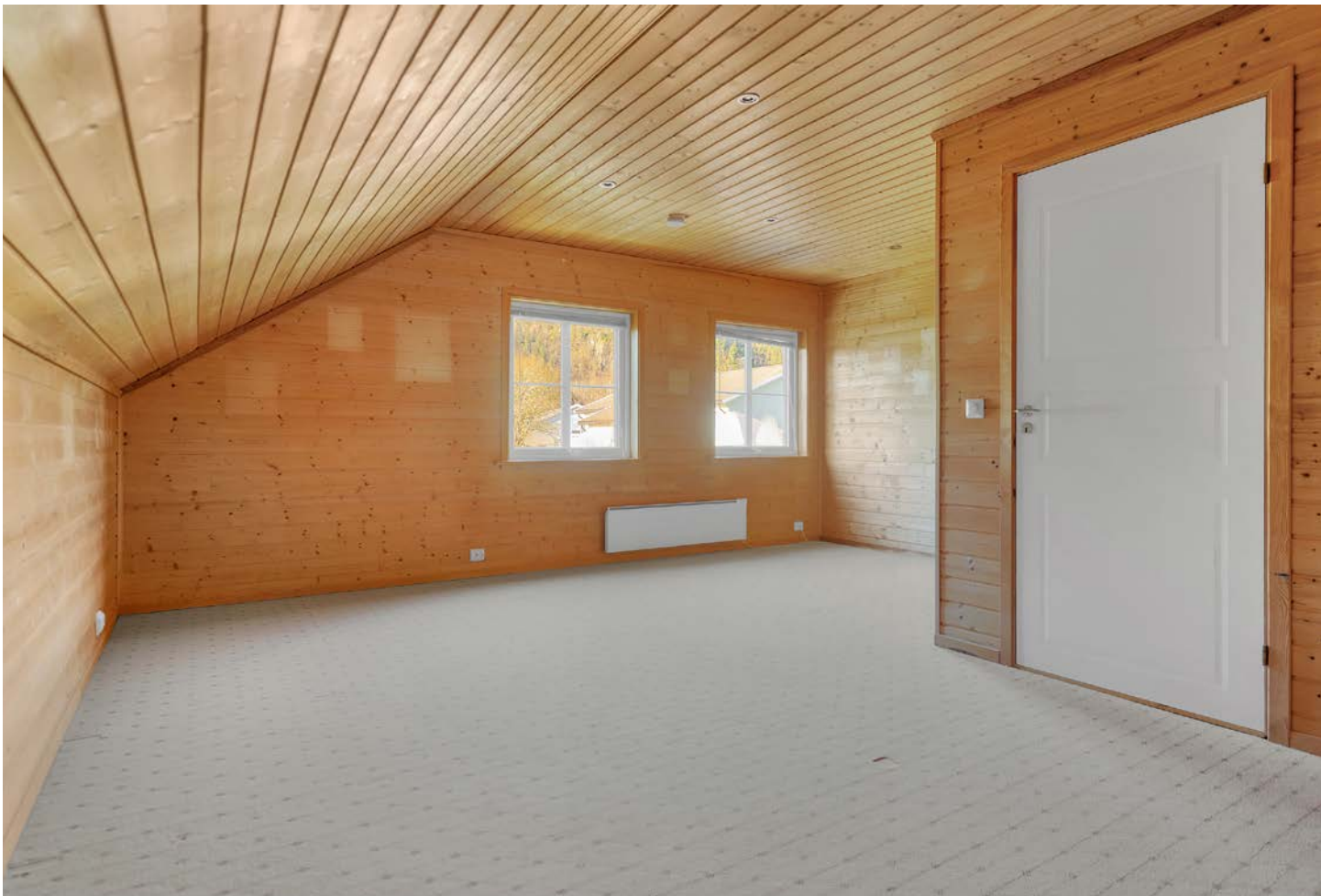
Innredet loft, ikke godkjent til varig opphold
