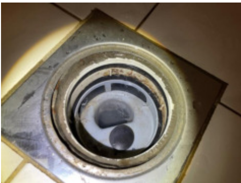
Synlig membran i dusjsluk
