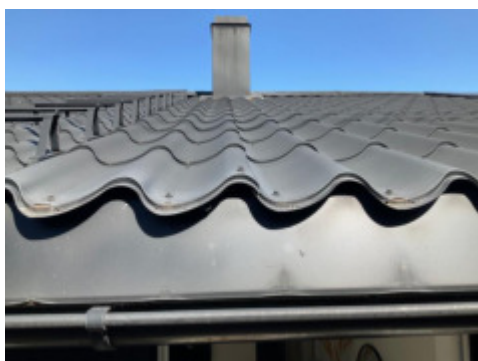
Takplater med noe løsnet plastbelegg på endeskjøt
