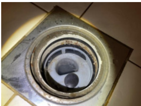
Synlig membran i dusjsluk
