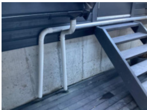
Nedløp ved garasjen bør ledes vekk på en bedre måte
