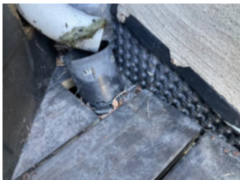
Taknedløp må ledes "bedre" ned i overvannsrør
