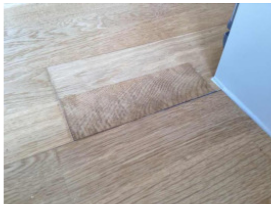
Et par lameller ved kjøleskap har bul etter vannsøl
