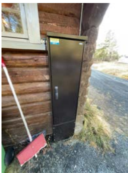
Utvendig skap med fjernavleser.
