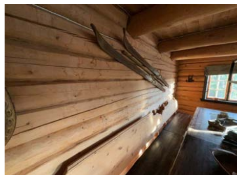
Utsnitt fuktmerker på tømmerkasse.
