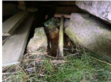
Stående vann på eiendommen mot pilarer.
