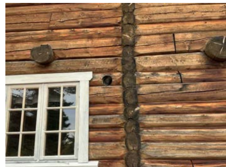
Manglende veggventil på yttervegg.
