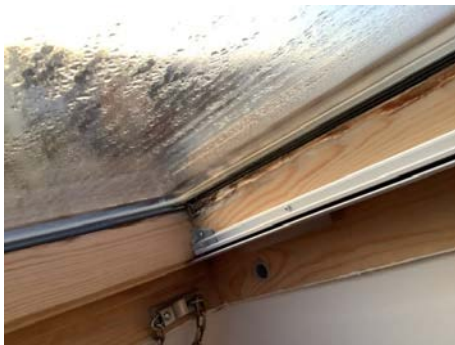
Fuktmerke på takvindu.
