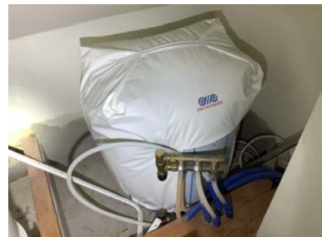
V.v.-bereder og synlig fordelersats til rørøppegget.
