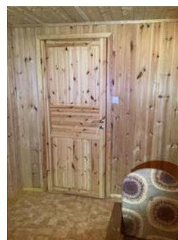
Dørblad til kjellerstue tar i terskel
