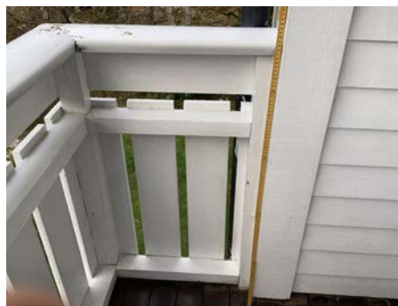
Rekkverk er lavere enn dagens krav
