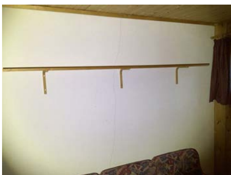
Sprekk i bærevegg i kjeller
