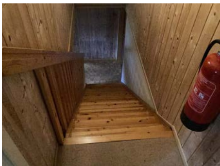
Det mangler håndløper på vegg i trappeløpet.
