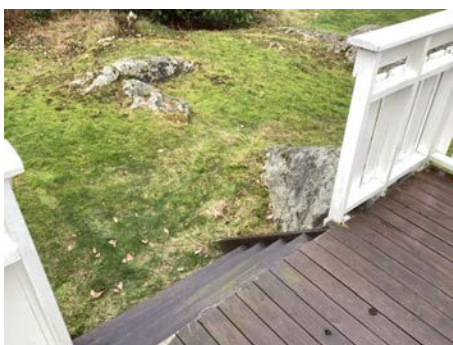
Det er ikke montert rekkverk.
