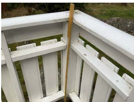
Rekkverk er lavere enn dagens krav
