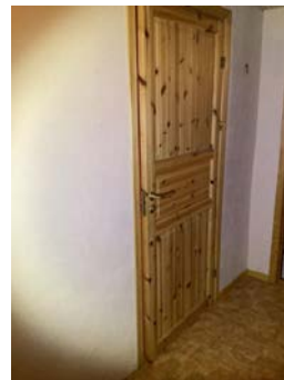
Dørblad til kjellerstue tar i terskel
