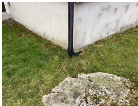
Skader i nedløpsrør
