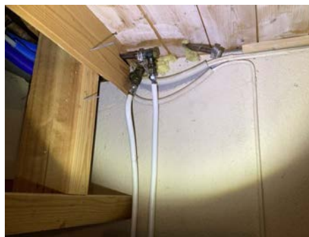
Kobberrør fra byggeår
