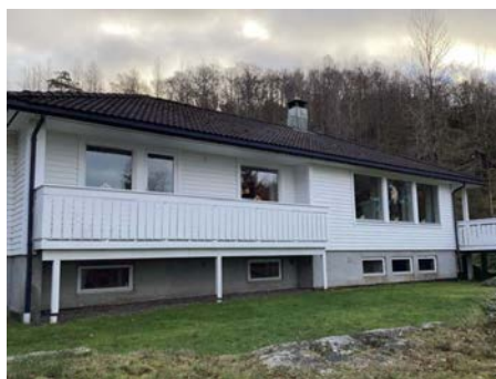
Taket har ikke snøfangere
