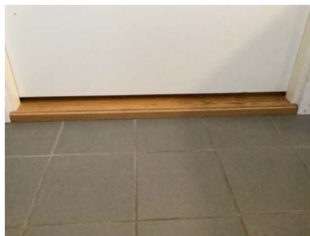
Spalte under dør
