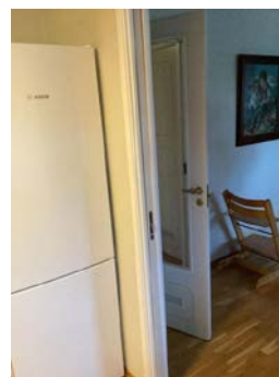
Skyvedør til kjøkken fungerer ikke.
