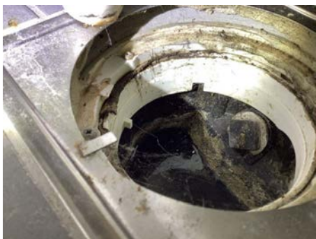
Påvist mansjett under klemring i sluken
