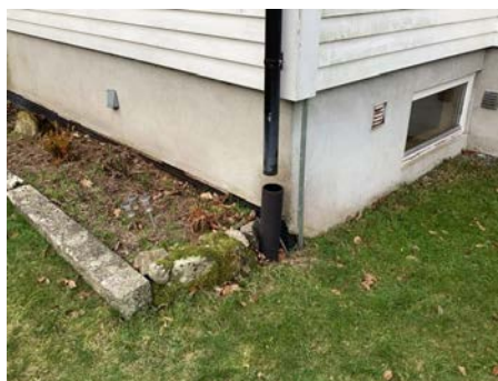
Nedløpsrør er ikke koblet til
