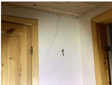
Sprekk i bærevegg i kjeller
