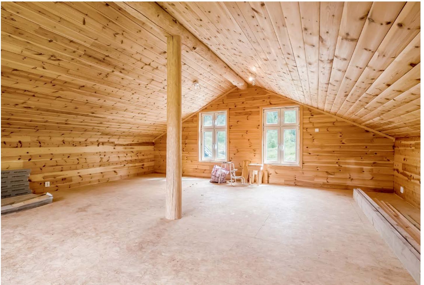
Innredet loft over garasje ( ikke godkjent )
