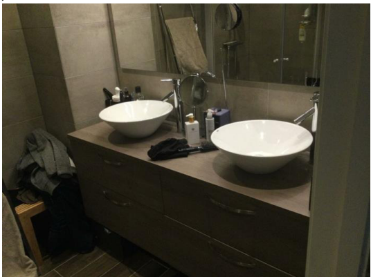
Baderomsinnredning med 2 vasker.
