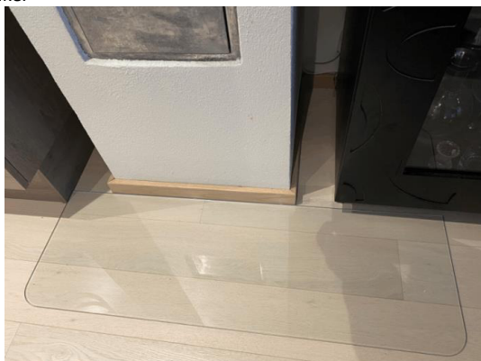
Brannsikker flate under feieluke.
