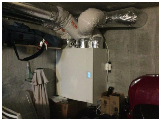
Balansert ventilasjons anlegg.
