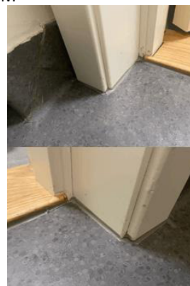
Silikon utført rundt lister, foringer og dørstokk på vaskerom.
